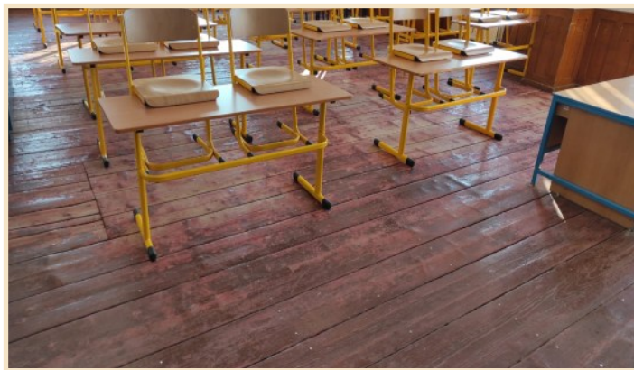
Podlaha ve třídě tercií před opravou
