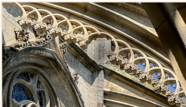
Poruchy opěrného systému chrámu svatě Barbory
