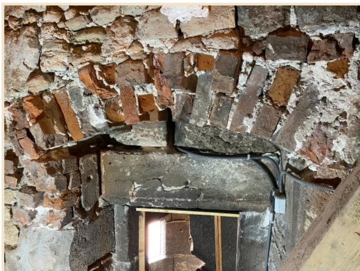
Staticky narušené ostění vstupu do krovu (stav 2023)
